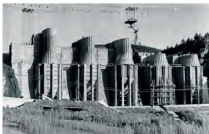
07 Návodní strana hráze, nátoky na elektrárnu, betonáž pomocí kabelových jeřábů. Zdroj: soukromý archiv Filipa Horkého.
