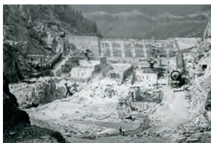
06 Betonáž spodní části hrázových bloků, po stranách potrubí spodních výpustí, v pozadí jímková hráz. Zdroj: soukromý archiv Filipa Horkého.
